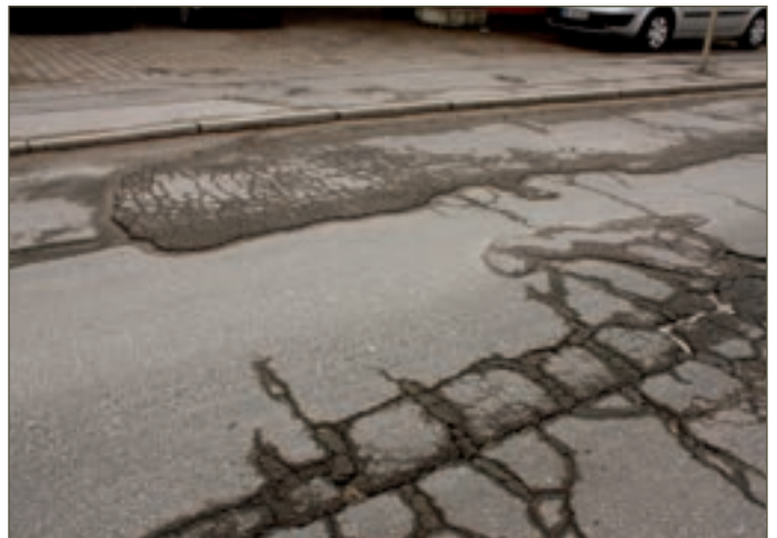
Oberflächenschäden in der Oesestraße
