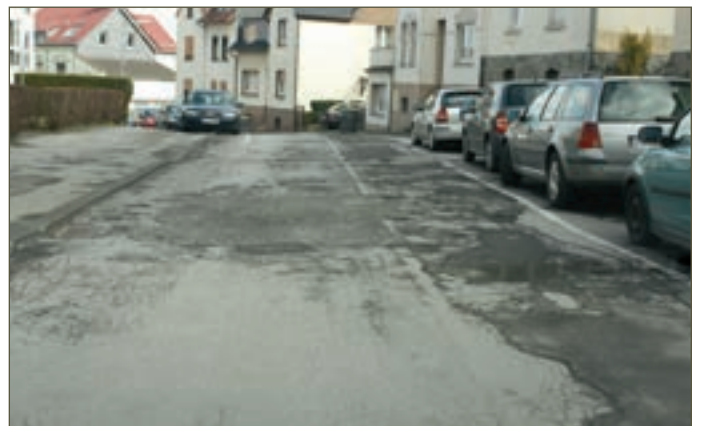
Erhöhte Oberflächenschäden in der Straße Am Ballo
